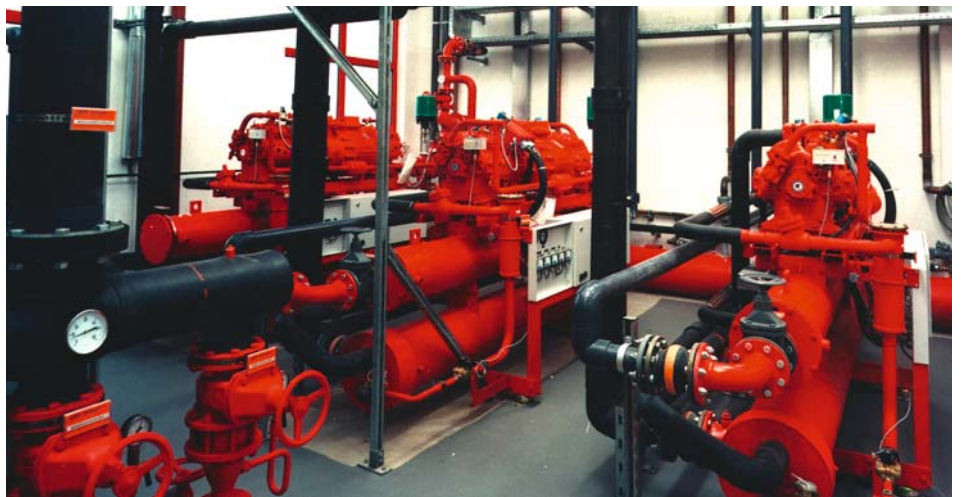
Containerinneres mit Kältemaschinen
