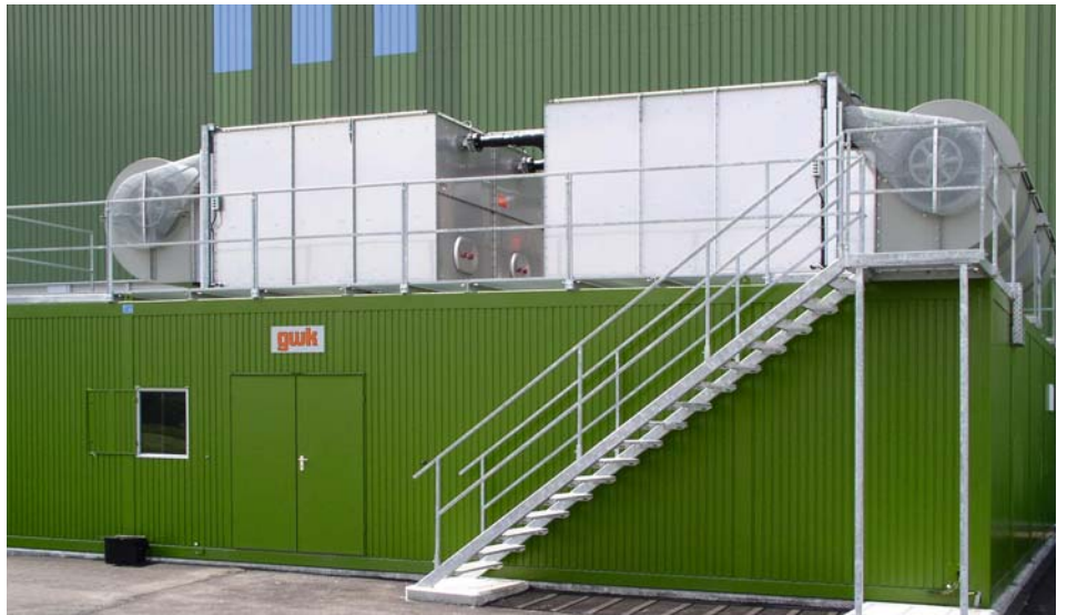
Container mit Kühlturm
