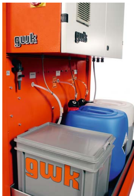
Station de dosage pour biocide et agent anticorrosion.
